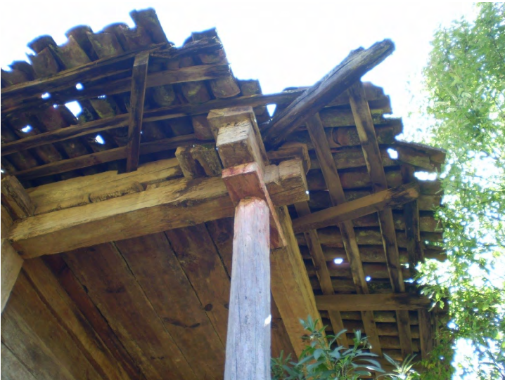
Imagen 122. Deterioro en cubierta. Fotografía: María de Jesús Moreno Estrada (2019).
