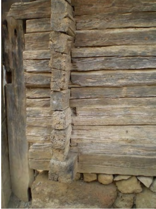
Imagen 15. Mampostería y ensamblaje de muros en troja. Fotografía: María de Jesús Moreno Estrada (2019).
