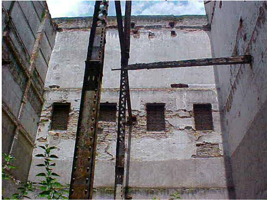
Oxidación de estructura metálica y pérdida de viguería (Fd11)
