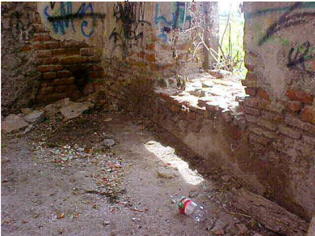
Se aprecia humedad en muros de ladrillo (Fd4)
