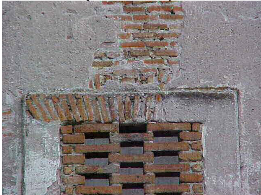
Pérdida de aplanados (Fd18)
