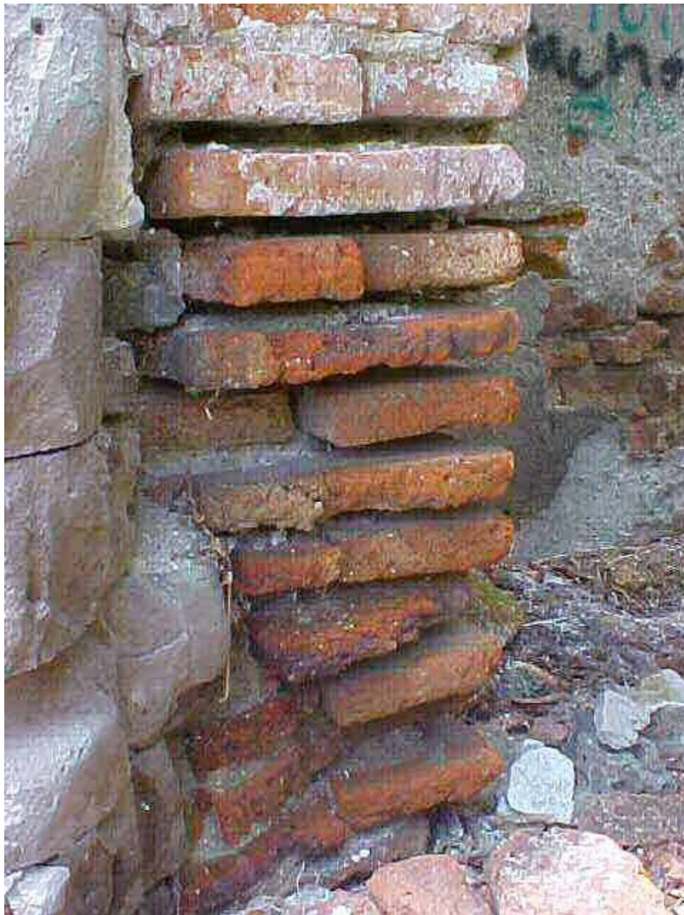
Pérdida de material en juntas (Fd10)
