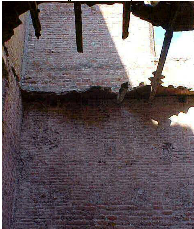
Colapso de cubiertas (Fd12)
