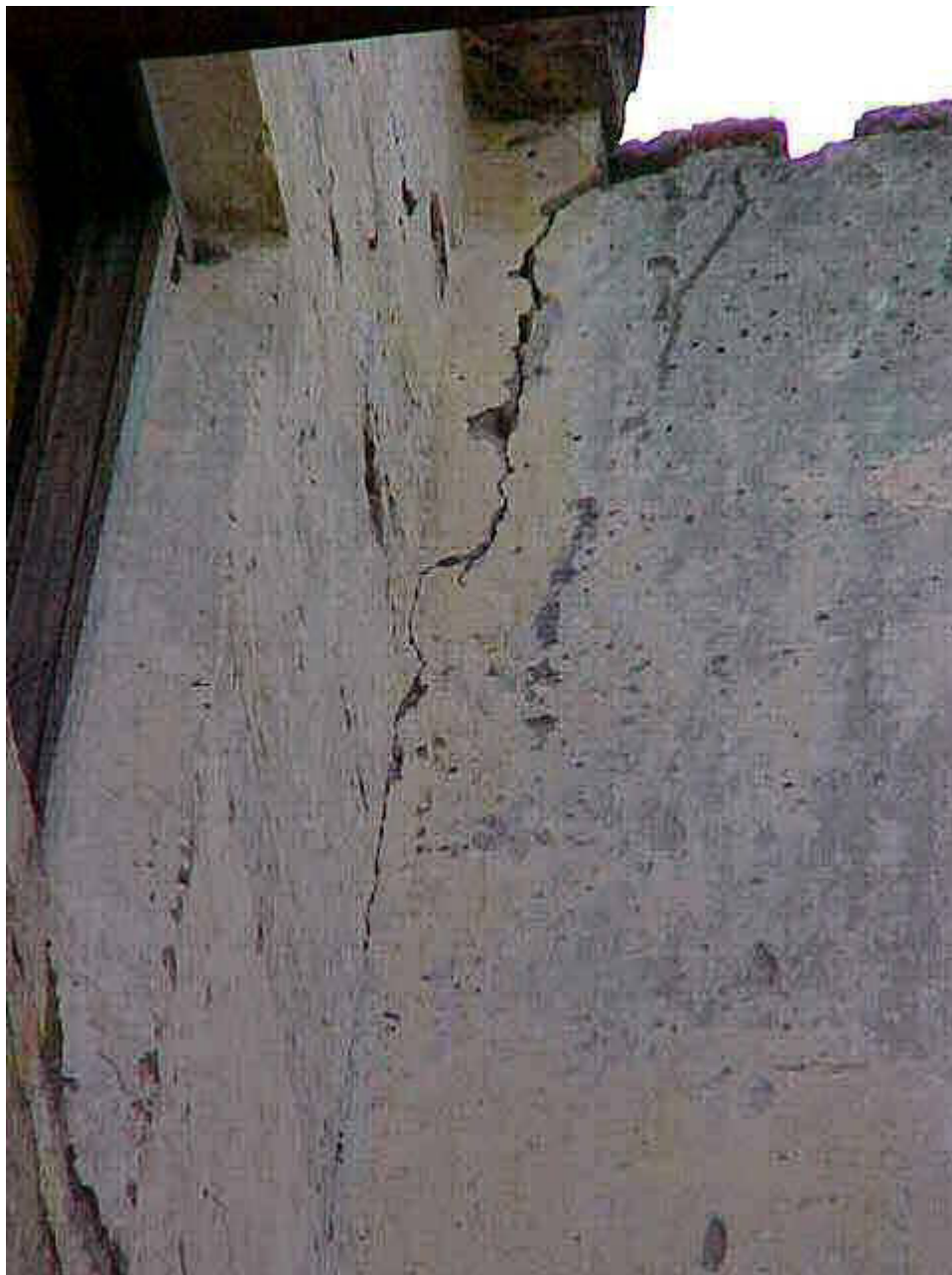
Grieta en unión de muros (Fd17)
