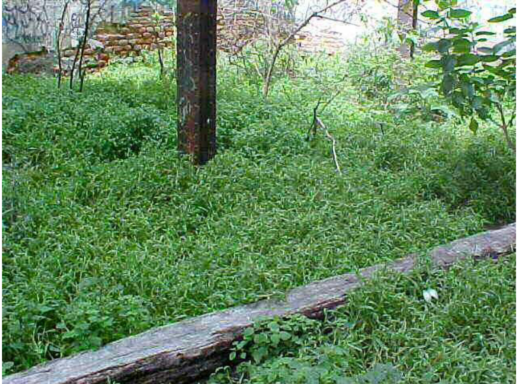
Escombros y vegetación (Fd13)
