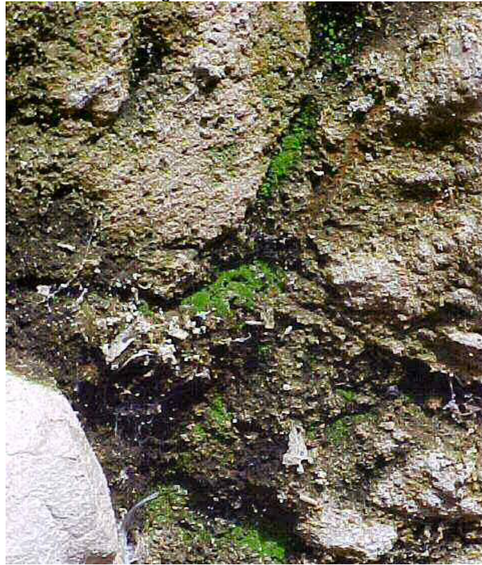
Presencia de musgo en muros (Fd5)
