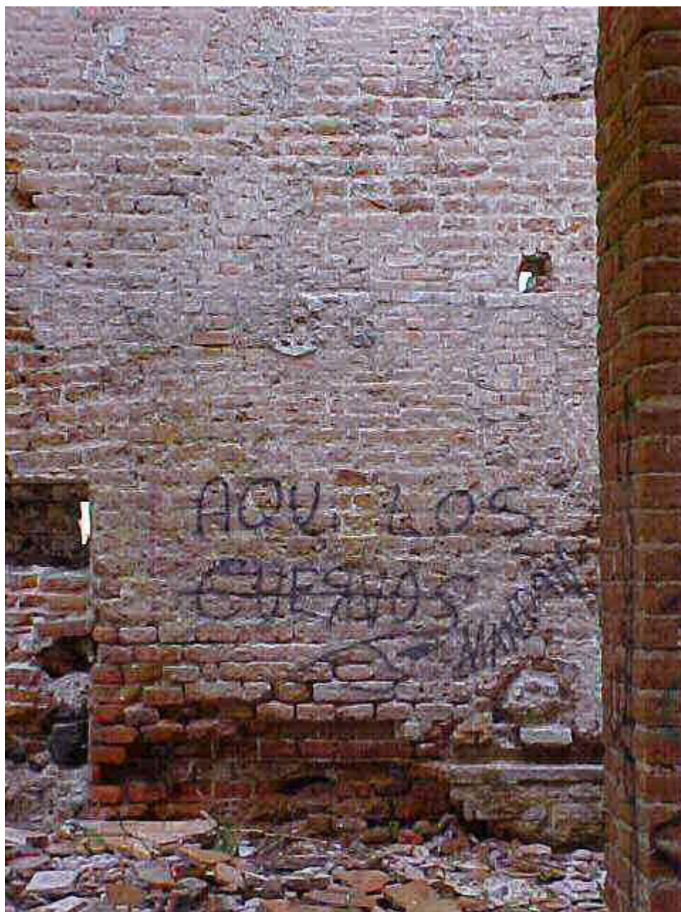
Se aprecia pérdida de material en muros (Fd9)
