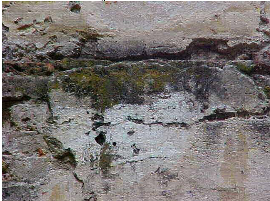
Líquenes en muros (Fd6)
