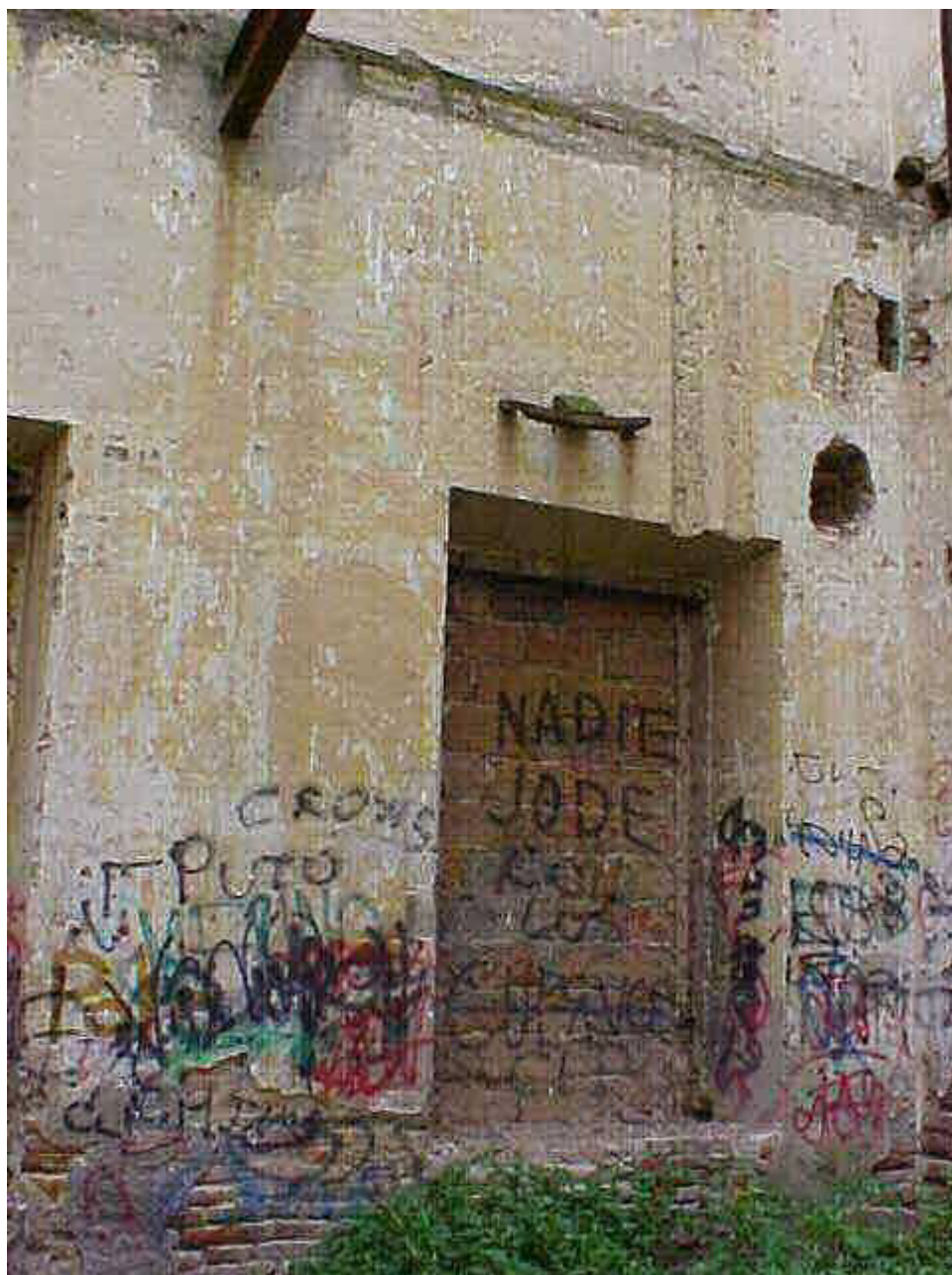
Decoloración de pintura y vandalismo (Fd20)
