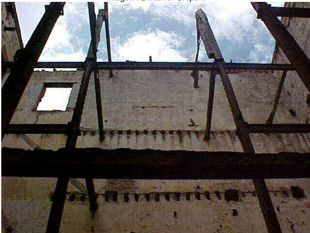
Dstrucción de vigería de madera por intemperización (Fd8)
