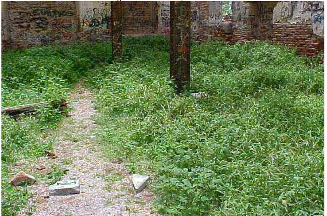
Escombros y vegetación en pisos (Fd14)
