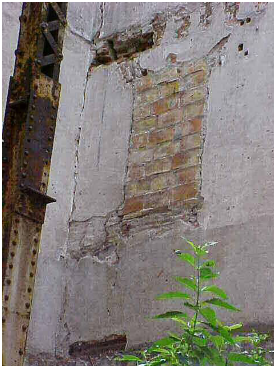
Grieta en muro y ventana (Fd16)
