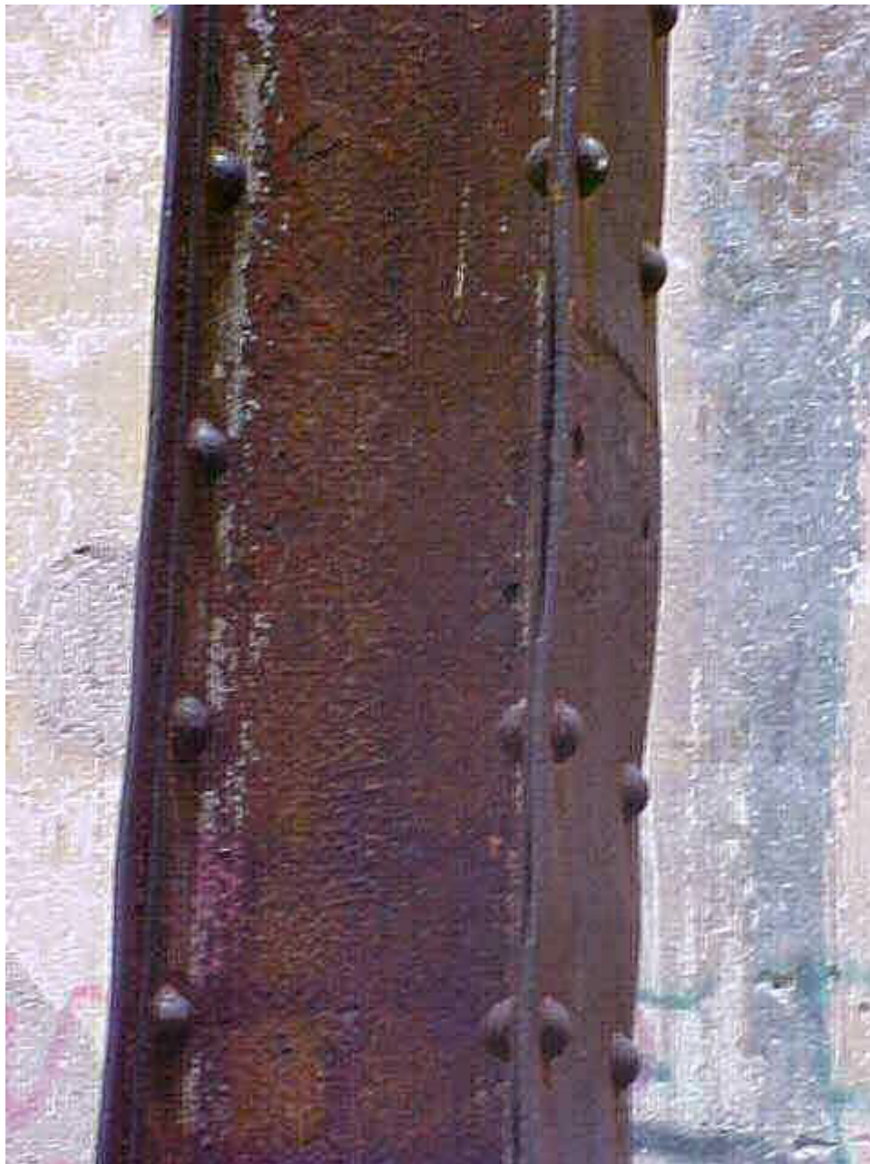
Alabeo y pérdida de remaches en columnas metálicas (Fd15)
