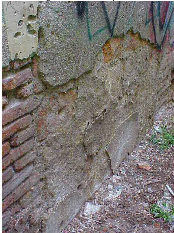
Exfoliación de aplanados (Fd19)
