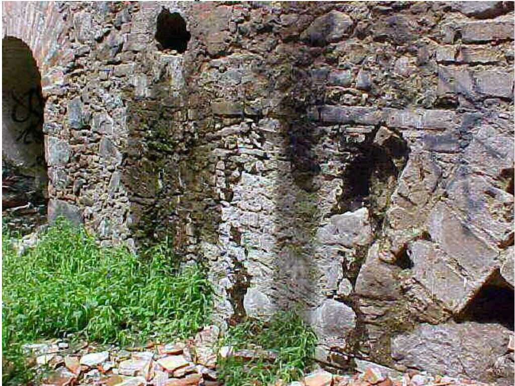
Se observa humedad en los cimientos de los Silos (Fd3)
