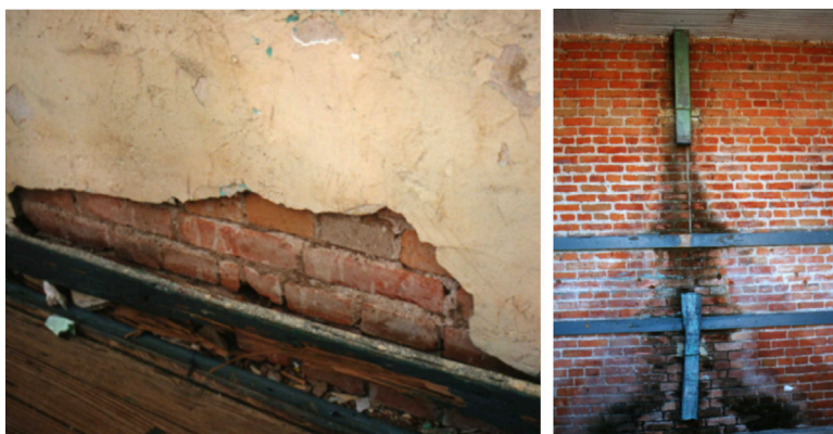
Figura 17 y 18. Deterioros de muros y pisos en los interiores y exteriores de las escuelas Centenarios. Interior de escuela Centenario, Dolores Hidalgo, Gto. Fotografía. T. Trueba, 2009, A. Pineda, 2010
