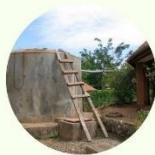
Sistema de Captación de agua
