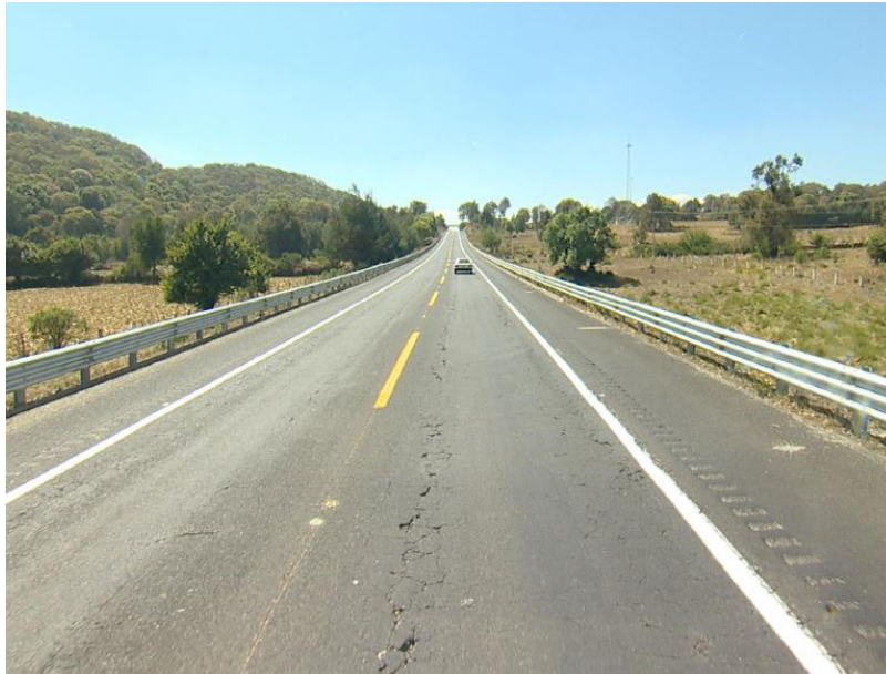
Figura 55. Vista del km 56+220. Agrietamiento severo en ambas rodadas.
