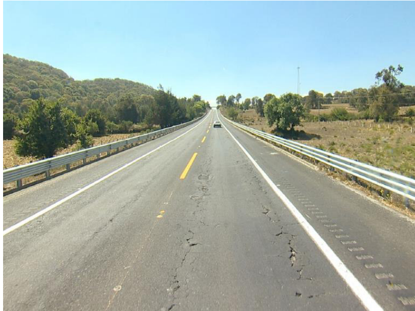
Figura 56. Vista del km 56+260. Agrietamiento severo en ambas rodadas, bombeo de finos en la rodada derecha.
