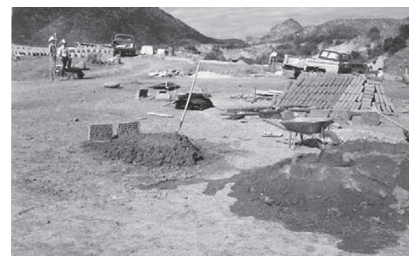
Figura 1. Casas en proceso de construcción con muros de adobe (AD) en Tarachi, Sonora, México.
