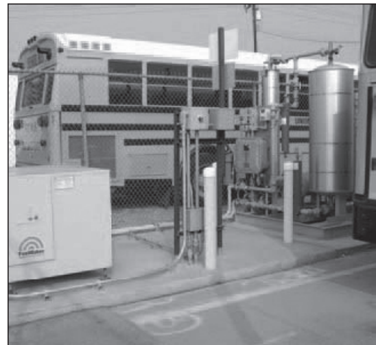
Figura 2. Subestación de gas natural para transporte urbano sustentable (Fuente:www.gncv.org).
