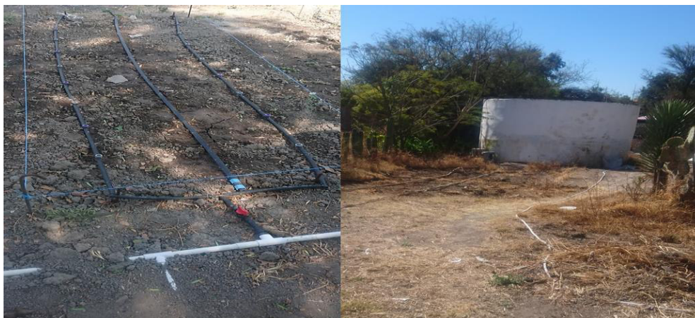
Figura 3 Sistema por goteo y tanque de ferrocemento recolector de agua pluvial
