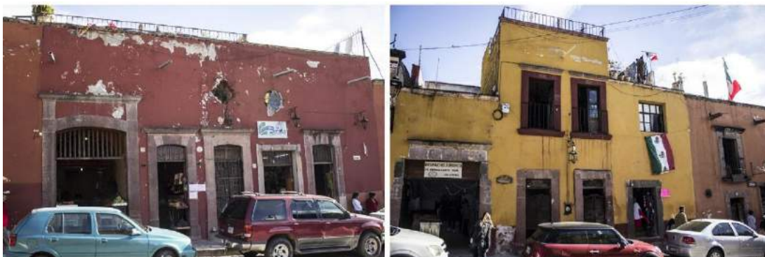
IMAGEN 57. ESTADO ACTUAL DE ALGUNOS INMUEBLES DEL SECTOR: CALLE DE LOS MESONES
