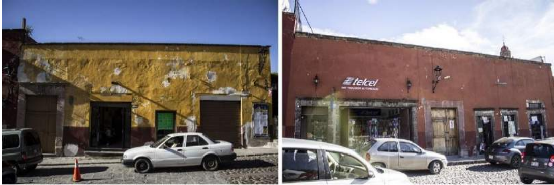
IMAGEN 56. ESTADO ACTUAL DE ALGUNOS INMUEBLES DEL SECTOR: CALLE DE LOS MESONES
