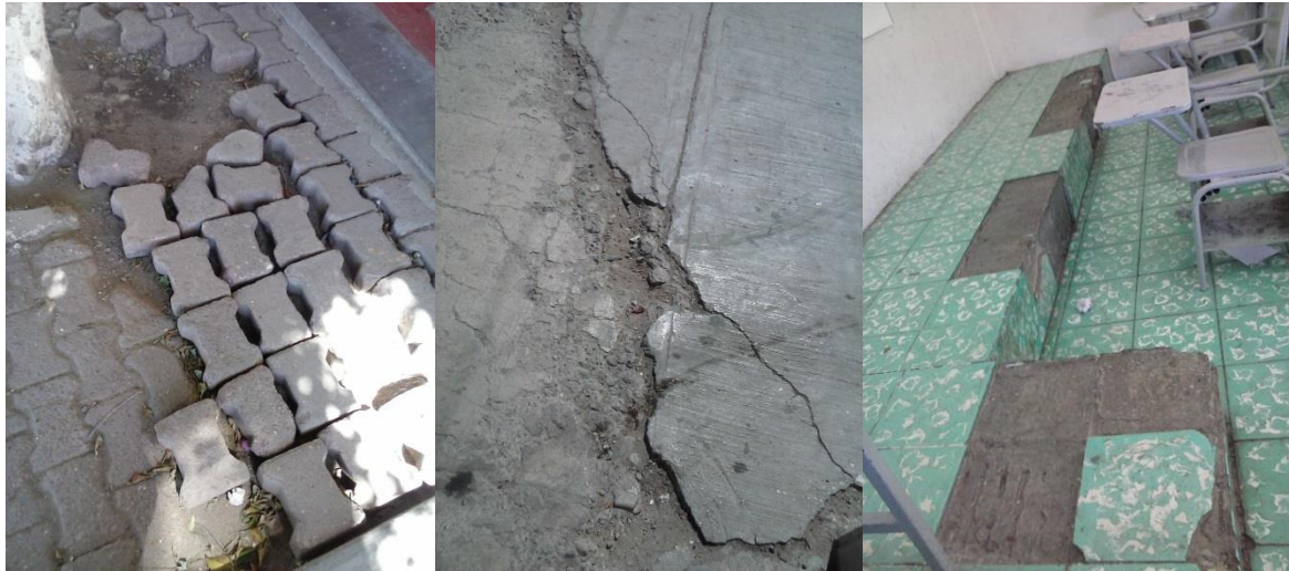
Ilustración 47 Detalles de pavimentos deteriorados
