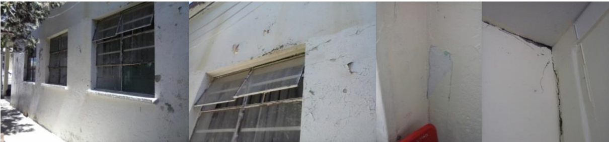
Ilustración 42 Deterioro en estructuras constructivas
