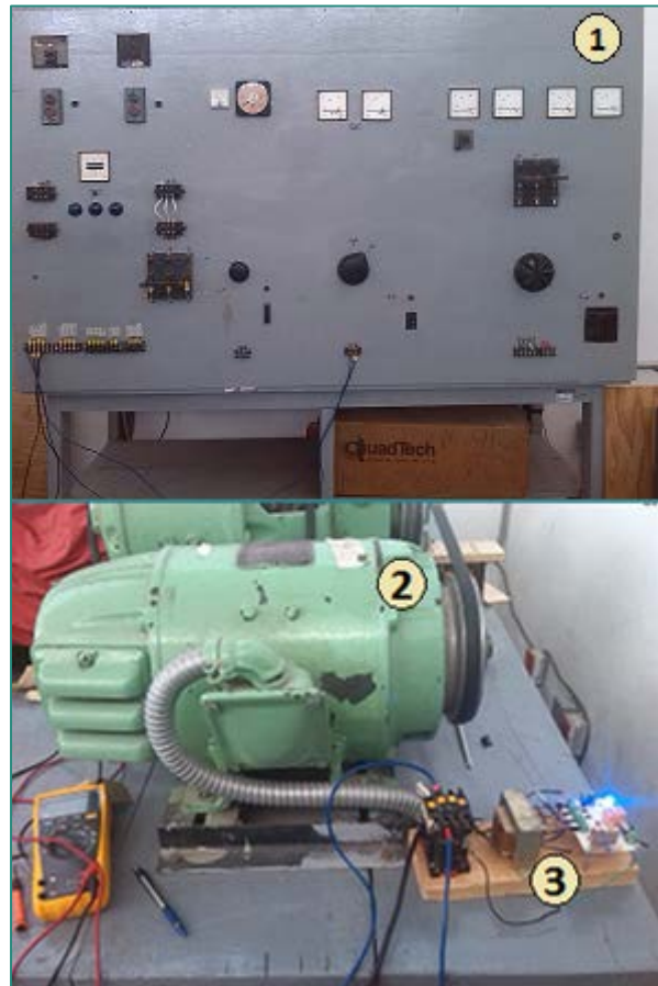
IMAGEN 8: Laboratorio de máquinas eléctricas de la DICIS: 1) Tablero donde se instaló la protección contra sobrevelocidad, 2) Motor 3HP-230Vdc y 3) Modulo de protección contra
