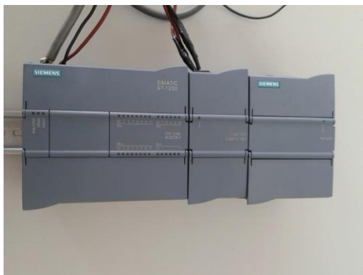
Figura 9. Módulos de subsistema de control, de izquierda a derecha, PLC siemens S7-1200, Modulo de comunicacion, fuente de alimentacion.
