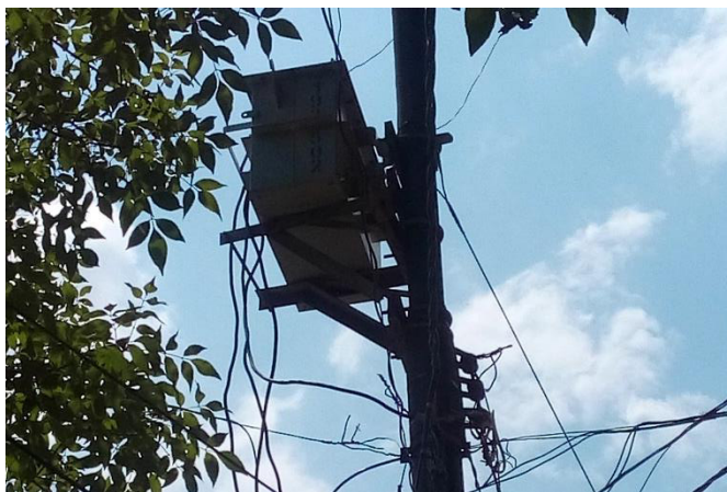
Ilustración 35: Transformador de la red de electrificación de la zona de estudio. Autoría propia.
