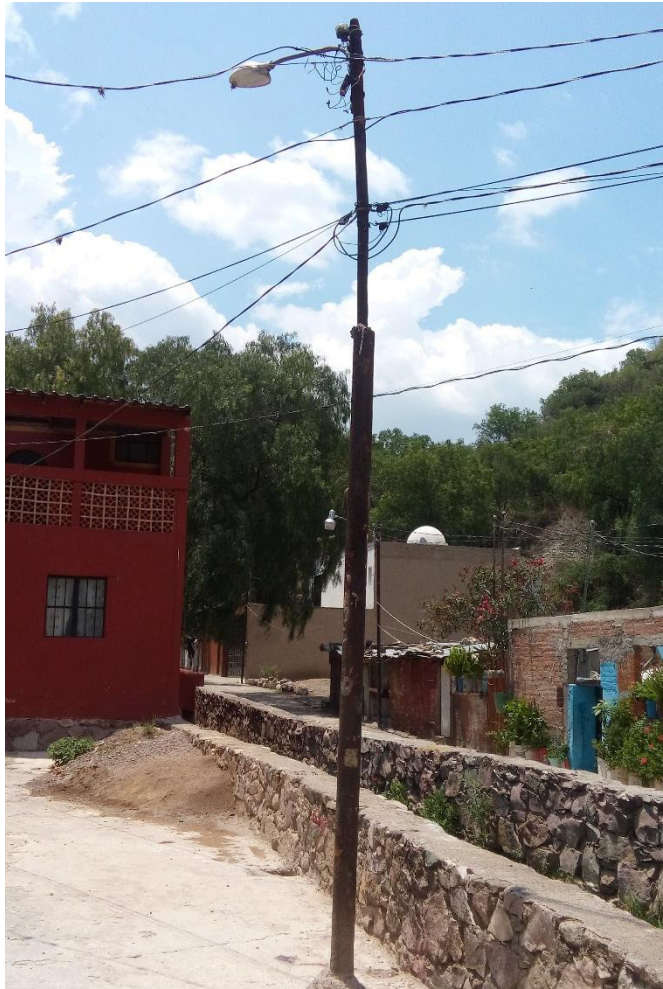
Ilustración 34: Luminaria en mal estado dentro del área de estudio. Autoría propia.
