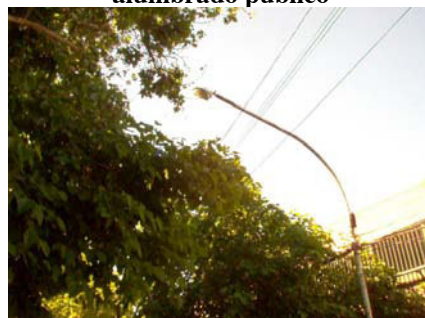
Fotografía 4.20 - Columna de alumbrado público
