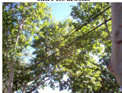
Fotografía 4.21 - Cables eléctrico entre los árboles
