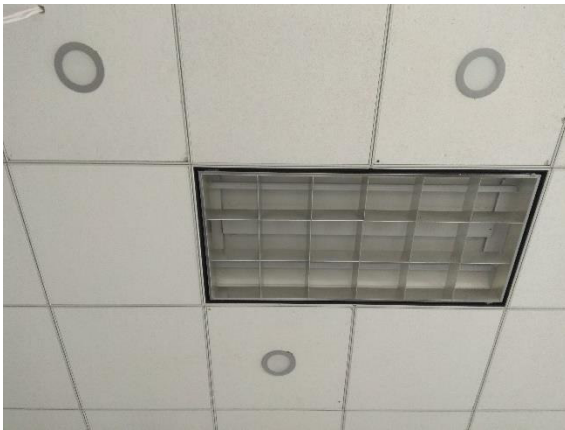
Figura 4.2. Triángulo de localización formado por tres lámparas en el techo.
