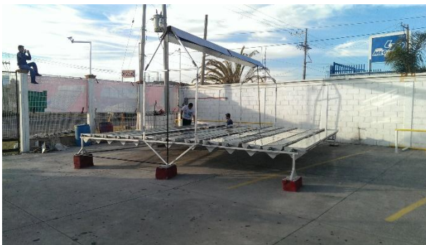
Figura 7. 21 Instalación de líneas de alimentación y de servicio del equipo.
