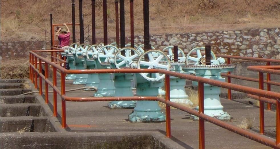
Fig. 30 Presa reguladora. Foto: A. Aguirre, 2006.
