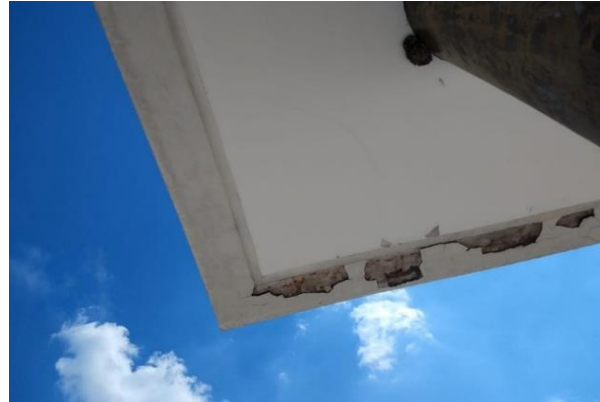
46. Deterioro de techo (Autoría: Propia, 2020)
