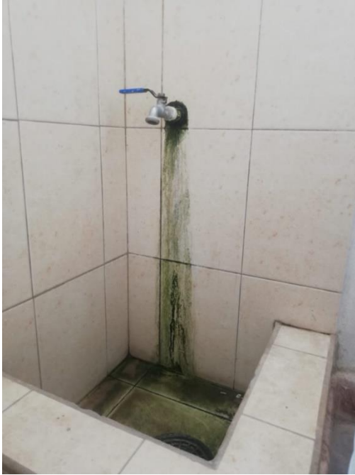
47. salidas de agua (Autoría: Propia, 2020)
