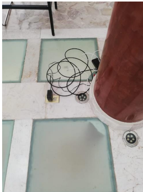
49. Luminarias (Autoría: Propia, 2020)
