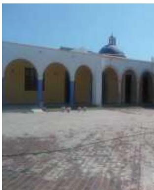
Zermeño Méndez, Salvador, se observa cómo se fueron forjando las boquillas de los arcos de punto de 38 cm de ancho y 7.5 cm de espesor promedio con cal apagada: "arena lavada proporción de 1:3 2017-01-19.
