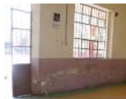
Zermeño Méndez, Salvador, humedad ascendente por capilaridad en el tercer salón de la crujía este, contigua al espacio de las escaleras de caracol para subir al segundo nivel, 2015-05 - 16.
