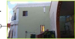
Pintura a la cal, preparada agregando a la mezcla sal previamente disuelta en agua, caseína, alumbre, en colores aceptados por el INAH, con pigmentos naturales, aplicado con brocha de cerdas naturales a cinco manos.
