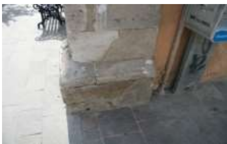
Zermeño Méndez, Salvador, exfoliaciones en la capa superficial de bases en pilastra de cantera, producto del intemperismo, en la esquina de las fachada de Hermenegildo Bustos y 5 de Mayo, 2015-05 -16.
