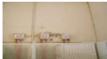
Zermeño Méndez, Salvador, En la imagen se ven los depósitos elevados de los sanitarios de los baños de niñas en la crujía este adosada al zaguán de entrada de la primera etapa de la escuela, 2016-05 -16.
