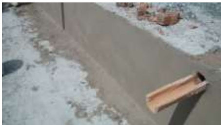
Zermeno Méndez, Salvador, se observa el forjado de pretiles a base de muro de ladrillo recocido de 14 cm. De espesor adherido con mortero cal apagada arena 1:3, 2016-04-18.
