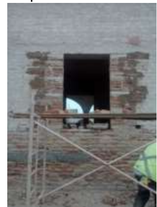
Zermeño Méndez, Salvador, En la imagen se ve la degradación del tabique y de la piedra porque en la parte superior del zócalo o rodapié a 1.70 m de altura del piso para evitar la humedad ascendente por capilaridad se manejó en el caso de la parte del inmueble de 1939, incluyendo una trabe de concreto que fue adosada, 2016-06 -10.
