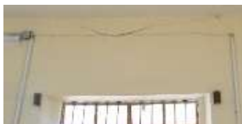
Zermeño Méndez, Salvador, lámparas Slim, colocadas sobre paredes con la existencia de cable eléctrico sin ninguna protección, en mal estado; en el tercer salón de la crujía oeste viniendo del acceso principal, 2015-05 -16.
