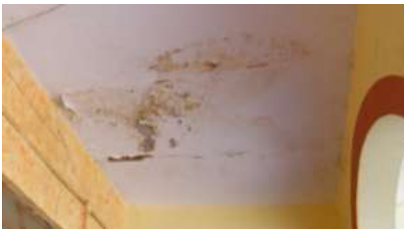
Zermeño Méndez, Salvador, humedad descendente por filtración, en la esquina del pórtico oeste y norte, oxidando las vigas IPR's, y la caída del aplanado del plafón y la pintura, 2015-05 -05.
