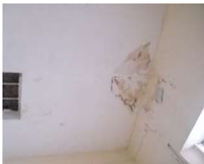
Zermeño Méndez, Salvador, humedad por filtración, en lo que va a ocupar el baño de hombres, en la losa de bóvedas escarzanadas e IPR's, 2015-05 -16.
