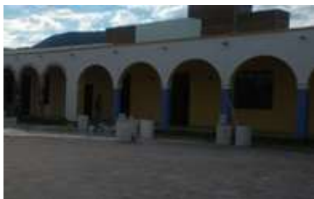
Zermeño Méndez, Salvador, se observa el muro blanco que oculta los nuevos tinacos, con una base de una losa que recibe los dos nuevos tinacos de 12 cm de espesor, 2017-01-19.
