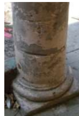
Zermeño Méndez, Salvador, humedad ascendente por capilaridad en columnas de cantera producto del adosamiento de jardineras, en el pórtico sur, generando exfoliaciones en la capa superficial de bases y el fuste; segundo fuste del pórtico sur, viniendo del oeste, 2015-05 -16.
