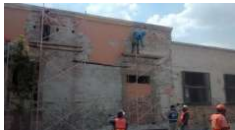
Zermeño Méndez, Salvador, se observa el retiro de aplanados en mal estado y a su vez las grietas que aparecen al exterior provocadas por esfuerzos cortantes provocados por los IPR's, por el cambio de la techumbre de madera, 2016-06-01.
