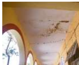
Zermeño Méndez, Salvador, humedad descendente por filtración, en la esquina del pórtico oeste con el pórtico norte en la losa de bóvedas escarzanas e IPR's, 2015-05 -16.
