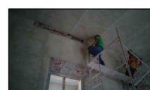
Retiro de aplanados actuales que pueden dañar los materiales de los muros, y para observar la dimensión total de las grietas en muro. Losas (Existente).
