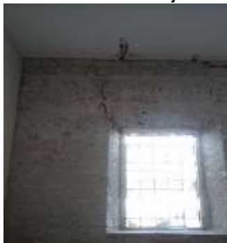
Zermeño Méndez, Salvador, se observa como el sistema constructivo fue a base de muros de piedra y una techumbre de terrado; a través de vigas de madera, esta techumbre fue sustituida en 1938, generando esfuerzos a lo que la estructura original no estaba diseñada;
