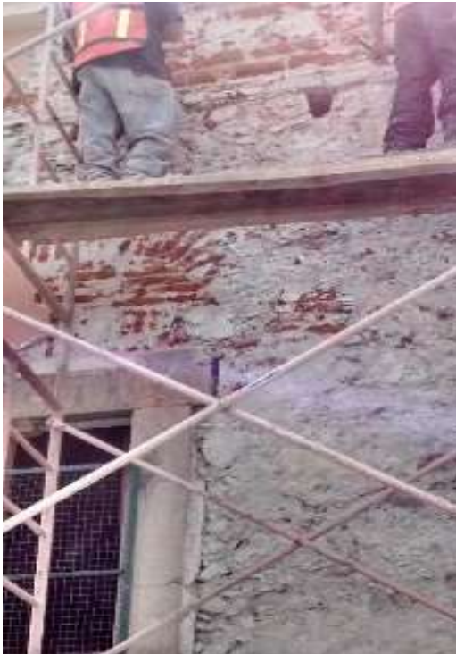
Zermeño Méndez, Salvador, se observa el retiro de aplanados en mal estado y a su vez las jambas y platabandas despegadas del muro de piedra, 2016-06-01.
