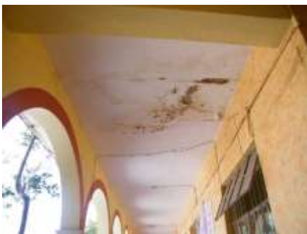
Zermeño Méndez, Salvador, humedad descendente por filtración, en la esquina del pórtico oeste y norte, oxidando las vigas IPR's, y La caída del aplanado del plafón y la pintura, 2015-05 -05.
