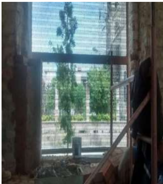
Zermeño Méndez, Salvador, se observa la reducción de vanos de ventanas verticales de la segunda etapa para abrir vanos verticales y a cada 3 hiladas se iba metiendo un tabique completo logrando el aparejo, 2016-05 -29.
