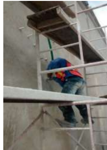
Zermeño Méndez, Salvador, se observa el procedimiento de la inyección de grietas en piedra a través de licuadora, previo cocido del muro, 2016-08 -11.
