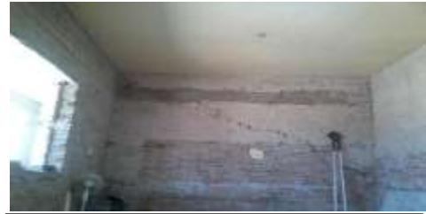
Zermeño Méndez, Salvador, se observa en la crujía norte, en el muro oeste las grietas diagonales que se dieron por la falta de unidad del coronamiento de la trabe superior, 2016-06-10.
