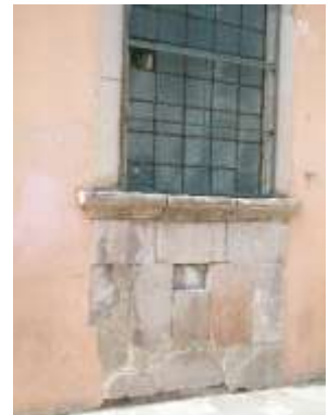
Zermeño Méndez, Salvador, exfoliaciones en la capa superficial y pérdida de piezas de la cantera de bases de ventanas, jambas y platabandas, producto del intemperismo, en la calle de 5 de Mayo, 2015-05 -16.
