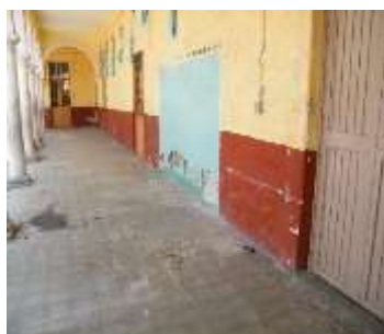
Zermeño Méndez, Salvador, humedad ascendente por capilaridad en el primer salón de la crujía sur, donde se ve el desprendimiento del enlucido de cal
