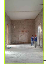
Muro de Piedra braza (Existente, espesor 0.70 M-1.00 M). Retiro de aplanados actuales que pueden dañar los materiales de los muros, y para observar la dimensión total de las grietas en muro.
