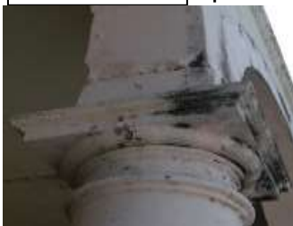
Zermeño Méndez, Salvador, humedad descendente en capiteles de columnas de cantera, despostillando algunas esquinas, producto de gárgolas rotas que provoca que el agua caiga directamente sobre la pieza, en la crujía sur, en el segundo arco del pórtico sur, viniendo del pórtico este, 2015-05 -16.
