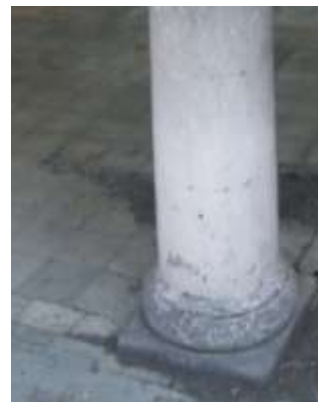
Zermeño Méndez, Salvador, humedad ascendente por capilaridad en columnas de, en el pórtico este, generando exfoliaciones en la capa superficial de bases; segunda columna de cantera del pórtico este, hacia el sur. 2015-05 -16.
