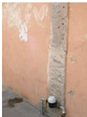
Zermeño Méndez, Salvador, exfoliaciones en la capa superficial de la cantera de jamba en puerta tapeada que funcionaba en la primera etapa de la escuela como acceso principal, producto del intemperismo, en la calle Hermenegildo Bustos, 2015-05 -16.
