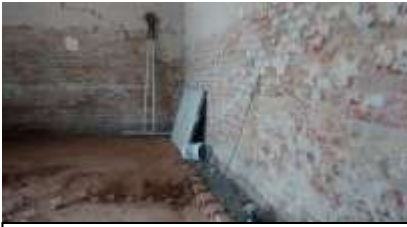
Zermeño Méndez, Salvador, se observa la capa tepetate y la capa de grava en el perímetro; el primero para recibir el firme y la grava en el perímetro para que el suelo respire y la humedad ascendente por capilaridad no llegue a los muros, en la cruja norte en lo que comprenderá el área lúdica, 2016-04-29.
