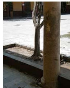
Zermeño Méndez, Salvador, presencia de jardineras adosadas a las bases de las columnas de cantera, cuya humedad se pasó a los fustes de las columnas de cantera, en el pórtico sur, 2015-05 -16.
