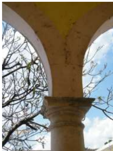
Zermeño Méndez, Salvador, Falta de juntas en las piezas de cantera donde se dan los cortes de la estereotomía de cada dovela, que se da en los pórticos de cantera sur y este. 2015-05 -16.
