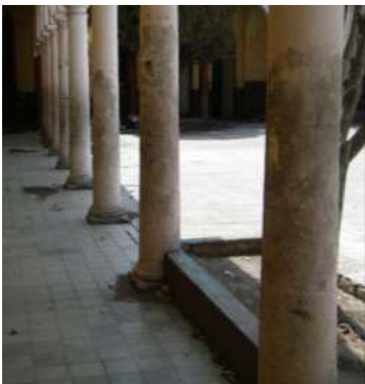
Zermeño Méndez, Salvador, humedad ascendente por capilaridad en columnas de cantera producto del adosamiento de jardineras, en el pórtico sur, generando exfoliaciones en la capa superficial de bases y el fuste, 2015-05 -16.
