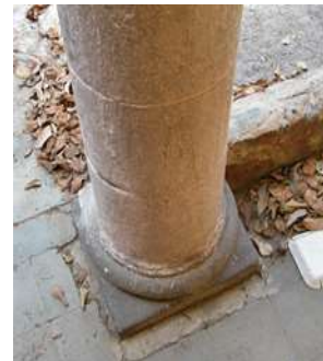
Zermeño Méndez, Salvador, humedad ascendente por capilaridad en columnas de cantera producto del adosamiento de jardineras, en el pórtico sur, generando exfoliaciones en la capa superficial de bases, 2015-05 -16.
