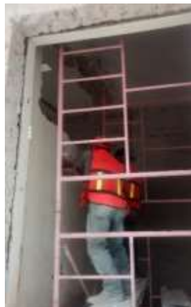
Zermeño Méndez, Salvador, se observa liberación de muro de tabique con castillos armados en la sala de la colección Hermenegildo Bustos 3, 2016-04-22.
