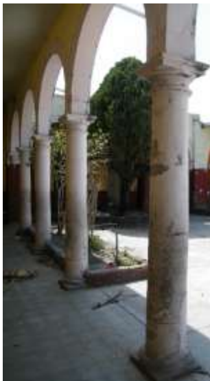
Zermeño Méndez, Salvador, pórtico sur, se observa como los fustes de cantera fueron pintados con pintura vinílica, además de la presencia de jardineras adosadas a las bases de las columnas de cantera, cuya humedad se pasó a los fustes, 2015-05 -16.
