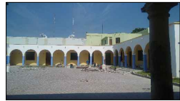
Aplanado de mortero de a base de cal apagada y arena, en muros de tabique rojo, a plomo y regleado, afinado con liana de madera. Muro de tabique rojo (Existente).
