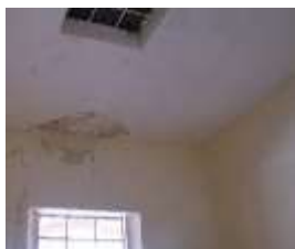
Zermeño Méndez, Salvador, humedad por filtración, en lo que va a ocupar el baño de hombres, en la losa de bóvedas escarzanas e IPR's, 2015-05 -16.
