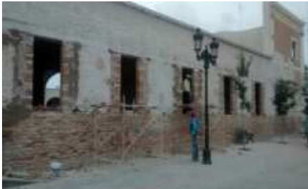
Zermeño Méndez, Salvador, En la imagen se ve la degradación del tabique y de la piedra porque en la parte superior del zócalo o rodapié a 1.70 m de altura del piso para evitar la humedad ascendente por capilaridad se manejó en el caso de la parte del inmueble de 1939,
