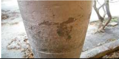
Zermeño Méndez, Salvador, Pintura vinílica en fuste de columna de cantera, que genera un deterioro, 2015-05 -16.
