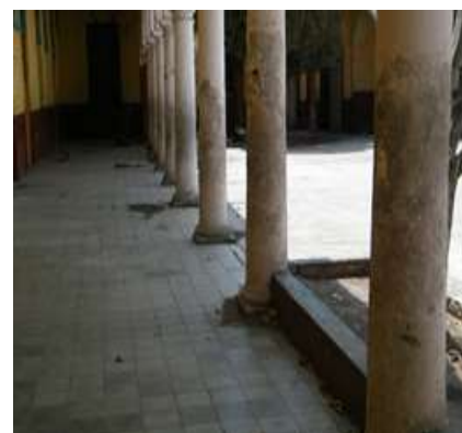
Zermeño Méndez, Salvador, humedad ascendente por capilaridad en columnas de cantera producto del adosamiento de jardineras, en el pórtico sur, generando exfoliaciones en la capa superficial de bases y el fuste, 2015-05 -16.
