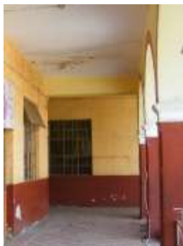
Zermeño Méndez, Salvador, humedad descendente por filtración, en la esquina del pórtico oeste y norte, oxidando las vigas IPR's, 2015-05 -05.
