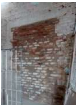
Zermeño Méndez, Salvador, tapeado de ventana en espacio para recepción y SITE y a cada 3 hiladas se iba metiendo un tabique completo logrando el aparejo tanto en reducción de vanos de la fachada principal como en el cierre de vanos del lugar donde se encontraba la escalera, 2016-05 -27.
