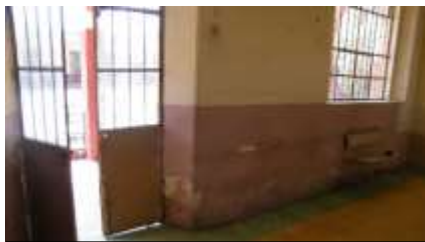
Zermeño Méndez, Salvador, humedad ascendente por capilaridad en el primer salón de la crujía norte, contigua al espacio de las escaleras de caracol para subir al segundo nivel,
