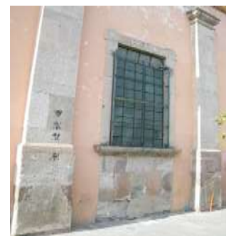
Zermeño Méndez, Salvador, pilastras de cantera y ventana, donde se observa que sus bases se encuentran exfoliadas producto del intemperismo, en la calle 5 de Mayo, 2015-05 -16.
