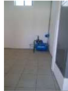
Zermeño Méndez, Salvador, En la imagen se ve el cuarto de máquinas en lo que va a funcionar también como bodega 2016-12 -15.
