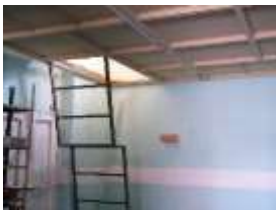
Zermeño Méndez, Salvador, se observa en la crujía oeste el espacio que fue destinado a la oficina del director de la escuela del cual se eliminó el mezzanine y la escalera marina, para construirse la bodega, 2015-05-16.
