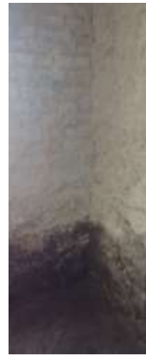
Zermeño Méndez, Salvador, se observa la capa de material relleno de 30 cm y la arcilla negra a 1 m de profundidad que fue donde se desarrolló la excavación para la mejora del suelo, en lo que comprenderá el área lúdica, 2016-04-08
