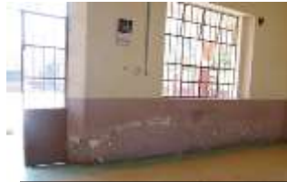
Zermeño Méndez, Salvador, humedad ascendente por capilaridad en el segundo salón de la crujía este, contigua al acceso principal, perdiéndose el enlucido, 2015-05 -16.
