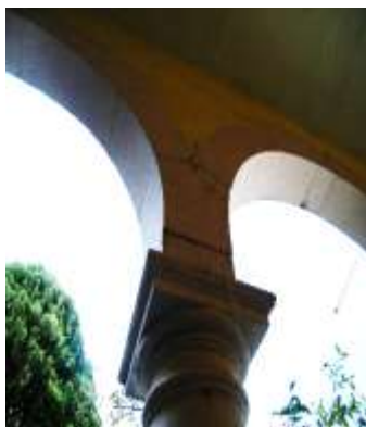
Zermeño Méndez, Salvador, desplazamiento del salmer de cantera y deslizamiento de la misma 4 mm, en el cuarto arco del pórtico sur, viniendo del pórtico este, 2015-05 -16.
