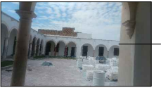
Aplanado de mortero de a base de cal apagada y arena, en muros de tabique rojo, a plomo y regleado, afinado con lana de madera. Muro de tabique rojo (Existente).
