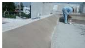
Zermeño Méndez, Salvador, se observan el aplanado de los pretiles y el chaffán para botar el agua hacia la azotea, 2016-08-16.
