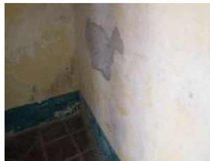
Zermeño Méndez, Salvador, humedad ascendente por capilaridad en el primer salón de la crujía este contigua al acceso principal, 2015-05 -16.
