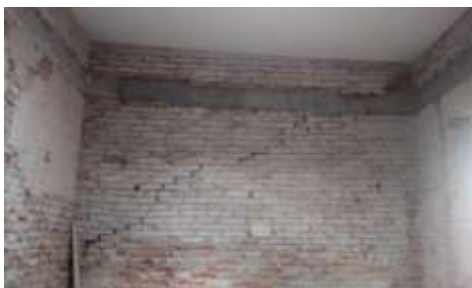
Zermeño Méndez, Salvador, se observa en la crujía norte, en el muro oeste las grietas diagonales que se dieron por la falta de unidad del coronamiento de la trabe superior; muro que fue eliminado para abrir el vano para lograr el espacio de continuidad requerido en el salón de usos
