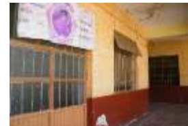
Zermeño Méndez, Salvador, se observa en el pórtico oeste, el tamaño del vano que existía y que fue reducido de acuerdo a la modulación vertical, para ubicar en ese espacio el taller de artes plásticas, antes del proceso de restauración, 2015-05-16.
