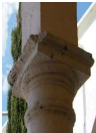
Zermeño Méndez, Salvador, humedad descendente en capiteles de columnas de cantera, despostillando algunas esquinas, producto de gárgolas rotas que provoca que el agua caiga directamente sobre la pieza, en la crujía sur, en el primer arco del pórtico sur, viniendo del pórtico este, 2015-05 -16.
