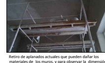
Retiro de aplanados actuales que pueden dañar los materiales de los muros, y para observar la dimensión total de las grietas en muro. Losas (Existente).
