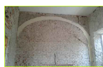
Retiro de aplanados actuales que pueden dañar los materiales de los muros, y para observar la dimensión total de las grietas en muro. Muro de Piedra braza (Existente, espesor 0.70 M-1.00 M).
