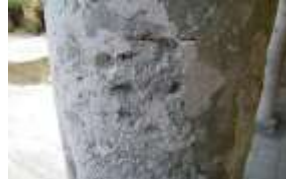
Zermeño Méndez, Salvador, Desgastes de columna, alveolización en el fuste, producto del intemperismo, en el pórtico sur, 2015-05 -16.
