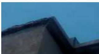
Zermeño Méndez, Salvador, se observa la integración de la nivelación de la cornisa de la primera etapa a la segunda etapa, perdiendo el desnivel en la esquina del contrafuerte, 2016-05-25.
