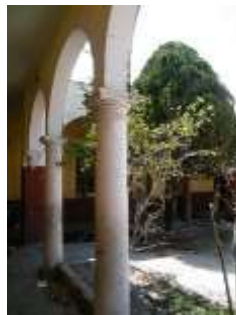
Zermeño Méndez, Salvador, humedad ascendente por capilaridad en columnas de cantera producto del adosamiento de jardineras, en el pórtico sur, generando exfoliaciones en la capa superficial de bases y el fuste, 2015-05 -16.
