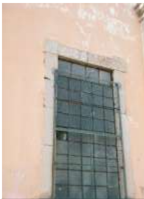
Zermeño Méndez, Salvador, exfoliaciones en la capa superficial y pérdida de piezas de la cantera de ventanas, jambas y platabandas, producto del intemperismo, en la calle de 5 de Mayo, 2015-05 -16.
