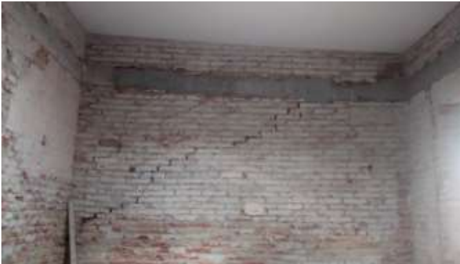
Zermeño Méndez, Salvador, se observa como la a estructura de las crujías de 1939 es a base de muros de carga, no existen castillos en las esquinas por lo que el aparejo del tabique lo hace fundamental, en calas desarrolladas, la cimentación es de zapatas corridas de 60 cm de profundidad por 50 cm de ancho; la estructura tiene una cadena perimetral que corona en su totalidad la crujía, sin embargo se detectan grietas diagonales lo que nos muestra una serie de hundimientos diferenciales; es el caso de la crujía donde se ubicó el salón de usos múltiples, 2016-05-25.
