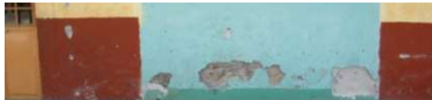
Zermeño Méndez, Salvador, humedad ascendente por capilaridad en el primer salón de la crujía sur, donde se ve el desprendimiento del enlucido de cal apagada, 2015-05 -16.
