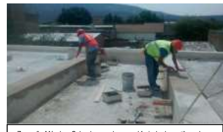
Zermeno Méndez, Salvador, se observa el forjado de pretiles a base de muro de ladrillo recocido de 14 cm. De espesor adherido con mortero cal apagada arena 1:3, 2016-04-29.
