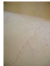
Zermeño Méndez, Salvador, grietas sobre muro de tabique de la crujía este de la etapa de 1938, en el primer salón, 2015-05 -16.
