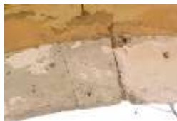
Zermeño Méndez, Salvador, abertura en la junta de la clave de cantera y deslizamiento de la misma 8 mm, en el cuarto arco del pórtico sur, viniendo del pórtico este, 2015-05 -16.
