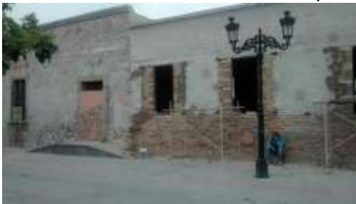
Zermeño Méndez, Salvador, En la imagen se ve la degradación del tabique y de la piedra porque en la parte superior del zócalo o rodapié a 1.70 m de altura del piso para evitar la humedad ascendente por capilaridad se manejó en el caso de la parte del inmueble de 1939, 2016-06 -10.
