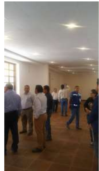
Zermeño Méndez, Salvador, se observa en la crujía norte el espacio que va a ser destinado para lo que será el salón de usos múltiples, también destinado para auditorio, en el momento en que fue la entrega recepción para la SOP y (Secretaría de Obra Pública) 2017-01-9.
