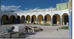
Aplanado de mortero de a base de cal apagada y arena, en muros de tabique rojo, a plomo y regleado, afinado con liana de madera. Muro de tabique rojo (Existente).
