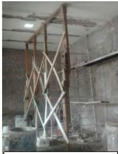
Zermeño Méndez, Salvador, se observa el apuntalamiento en la crujía sur en lo que comprenderá la sala de exposición temporal, al estar el muro de piedra agrietado por fuera y por dentro, proceso antes de la inyección. Apuntalamiento con polines, largueros y arrastres, 2016-05-18.
