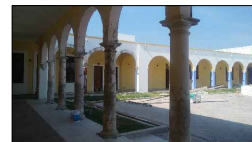
Aplanado de mortero de a base de cal apagada y arena, en muros de tabique rojo, a plomo y regleado, afinado con liana de madera. Muro de tabique rojo (Existente).
