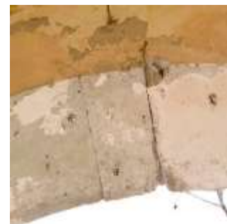
Zermeño Méndez, Salvador, abertura en la junta de la clave de la cantera y deslizamiento de la misma 7 mm, en el tercer arco del pórtico sur, viniendo del pórtico este, 2015-05 -16.
