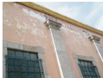
Zermeño Méndez, Salvador, exfoliaciones en la capa superficial de la cantera de pilastras, ventanas, jambas y plateabandas, producto del intemperismo, en la calle de 5 de Mayo, 2015-05 -16.
