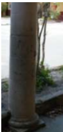
Zermeño Méndez, Salvador, humedad ascendente por capilaridad en columnas de cantera producto del adosamiento de jardineras, en el pórtico sur, generando exfoliaciones en la capa superficial de bases y el fuste; fuste de la esquina sur y este 2015-05 -16.
