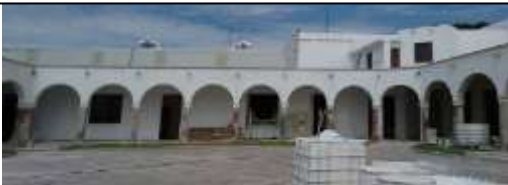
Zermeño Méndez, Salvador, patio principal, arcadas norte y este en la que se ve la segunda etapa de 1939, se ve el proceso de pintura a la cal, la etapa de fondeado , 2016-09-13.
