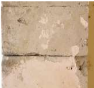
Zermeño Méndez, Salvador, Falta de juntas en las piezas de cantera donde se dan los cortes de la estereotomía de cada dovela, que se da en los pórticos de cantera sur y este. 2015-05 -16.
