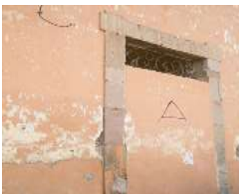
Zermeño Méndez, Salvador, puerta tapeada de la primera entrada que tuvo la escuela en la calle Hermenegildo Bustos, 2015-05 -16.
