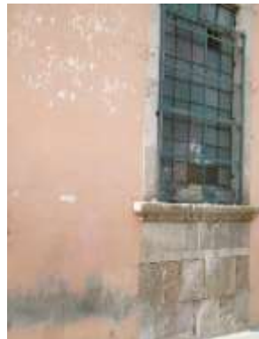
Zermeño Méndez, Salvador, exfoliaciones en la capa superficial y pérdida de piezas de la cantera de bases de ventanas, jambas y platabandas, producto del intemperismo, en la calle de 5 de Mayo, 2015-05 -16.
