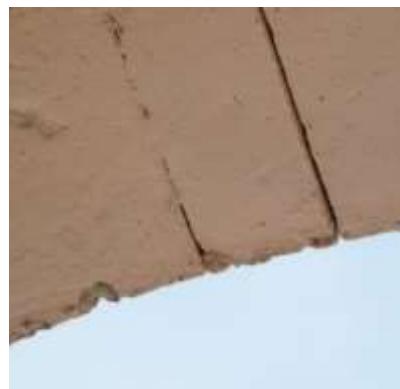
Zermeño Méndez, Salvador, abertura en la junta de la clave de cantera de 6 mm, en el cuarto arco del pórtico sur, viniendo del pórtico este, por lo que se hace necesario el acuñamiento del mismo, 2015-05 -16.
