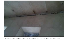
Retiro de aplanados actuales que pueden dañar los materiales de los muros, y para observar la dimensión total de las grietas en muro. Losas (Existente).
