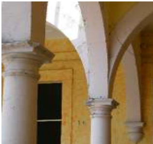
Zermeño Méndez, Salvador, humedad descendente en capiteles de columnas de cantera, despostillando algunas esquinas, producto de gárgolas rotas que provoca que el agua caiga directamente sobre la pieza, en la crujía sur, 2015-05 -16.
