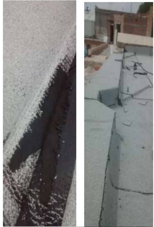
Zermeño Méndez, Salvador, En las 2 imágenes se observa la etapa final de la colocación del impermeabilizante termofusionado, autorizada por el INAH, en el chaflán y en el desagüe hacia la gárgola. 2016-04-25,
