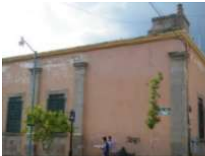
Zermeño Méndez, Salvador, fachada en la calle 5 de Mayo, se percibe el deterioro en los aplastados, en las canteras de pilastras y en los marcos de cantera de las ventanas el momento en que la escuela se desocupó para iniciar la restauración del centro cultural, 2015-05 -16.
