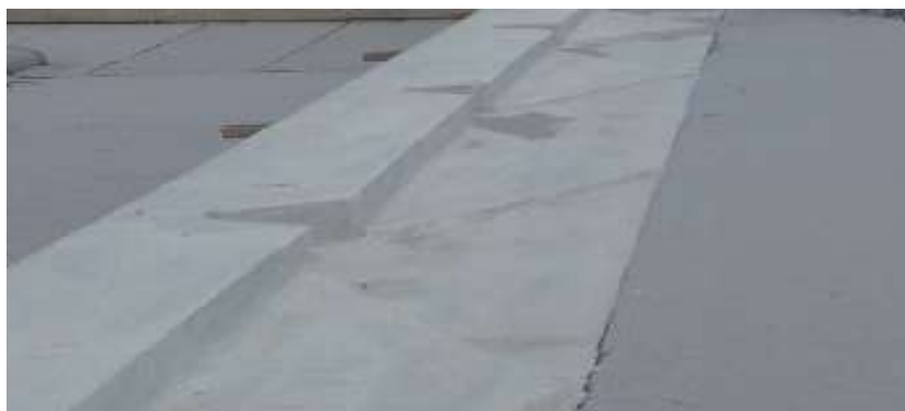
Zermeño Méndez, Salvador, se observa el canal del pretil abierto y encausado al lugar donde recibe el agua la gárgola de barro, 2016-08-16.
