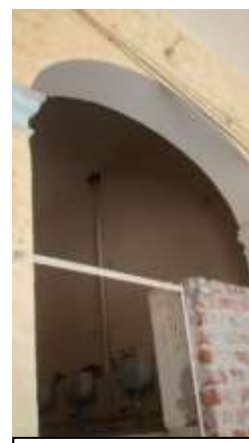
Zermeño Méndez, Salvador, se observa liberación de muro de tabique en lo que fueron los baños de la escuela de lo que va a ser la tienda de suvenires del Centro Cultural Hermenegildo Bustos
