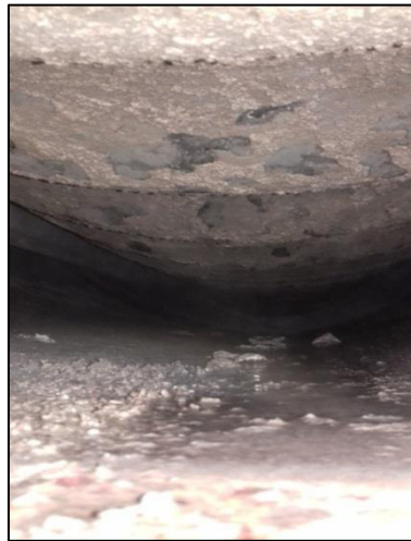
Figura 7. Fotografía del fondo de una caldera durante la limpieza del lado agua. (Fuente: fotografía de captura propia durante un mantenimiento a una caldera.)
