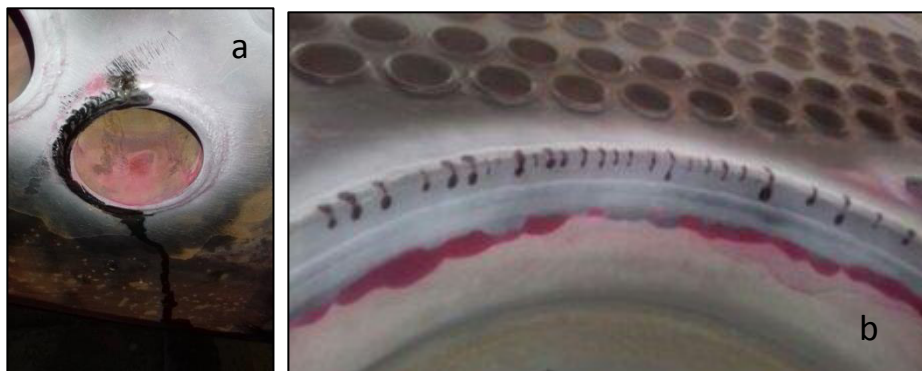
Figura 14. Daños en soldadura: a) Hallazgo de fuga en soldadura después de efectuar prueba hidrostática. El agua logra fugar hacia el lado fuego a través de la soldadura de un tubo flux. b) Hallazgo de daños superficiales en soldadura del hogar refractario al espejo utilizando el método de líquidos penetrantes. (Fuente: fotografía de captura propia durante un mantenimiento a una caldera.)
