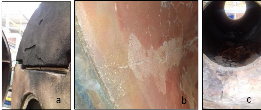
Figura 9. Daños en refractarios: a) Cuarteadura en tapa intermedia de refractario. b) Fractura en refractario de tapa posterior. Estas fracturas permiten que el calor penetre al interior del refractario y llega hasta la pared metálica ocasionando problemas en la tapa. c) Caída de ladrillos del refractario del quemador. (Fuente: fotografía de captura propia durante un mantenimiento a una caldera.)
