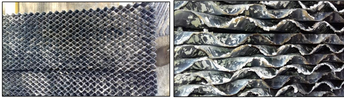
Figura 16. Relleno de torre de enfriamiento saturado de lodos e incrustaciones. (Fuente: fotografía de captura propia durante un mantenimiento a una torre de enfriamiento.)
