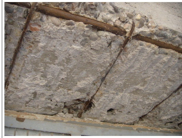
Figura 2.18: Agrietamiento y rompimiento del concreto (Anónimo, 2014).
