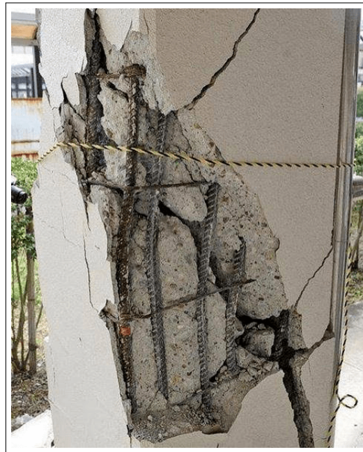
Figura 2.10: Falla por cortante en una columna de concreto reforzado (GeotechTips, 2016).
