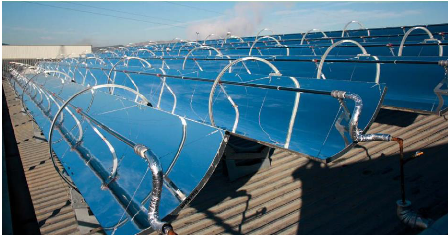
Figura 3.3 Campo de concentradores cilindro-parabólicos que suministran calefacción y refrigeración. Fuente: (Weiss & Spörk-Dür, 2019)
