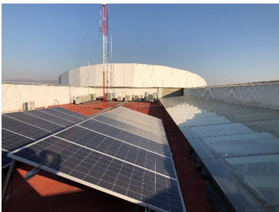
Ilustración 12. Paneles solares en estación de bomberos. Fuente: propia.
