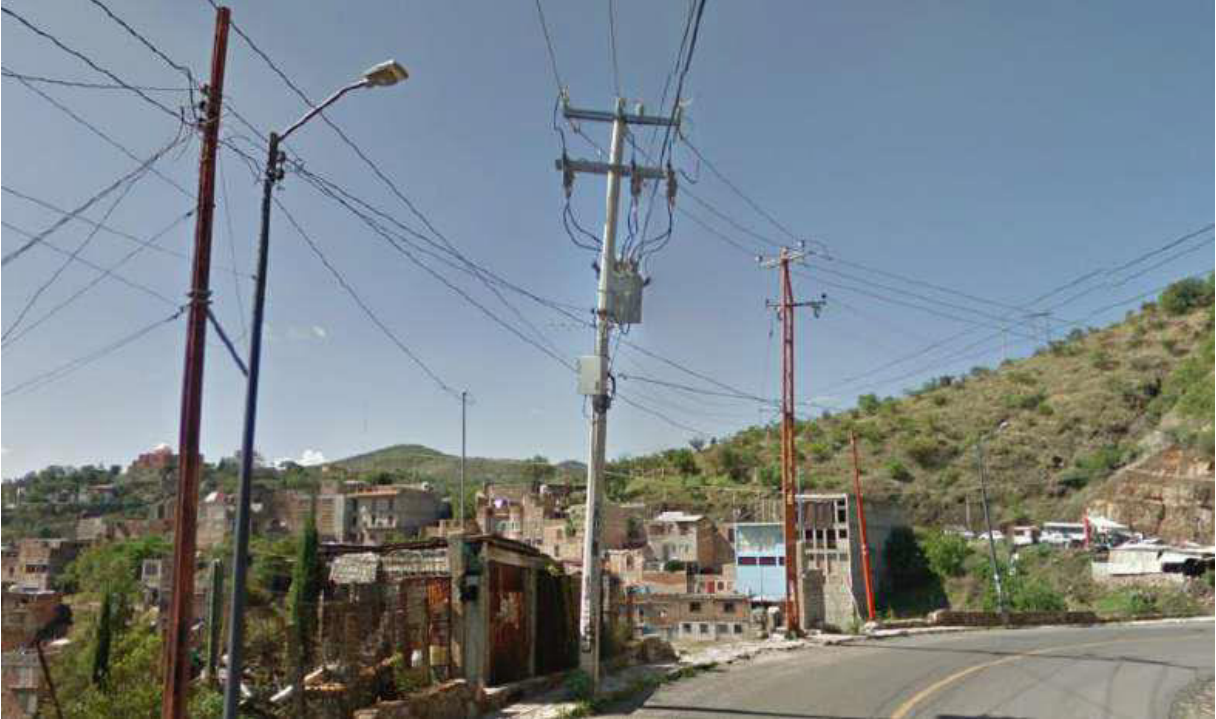
Fig 36: Transformador de la zona. Fuente: Propia.
