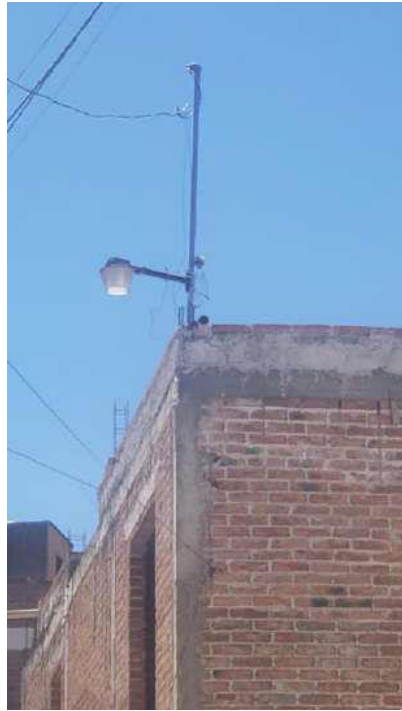
Fig. 38: Alumbrado público de casa después del callejón. Fuente: Propia.
