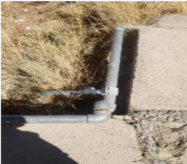
Fig. 35: Tubería de la cual se tomará el agua. Fuente: Propia.
