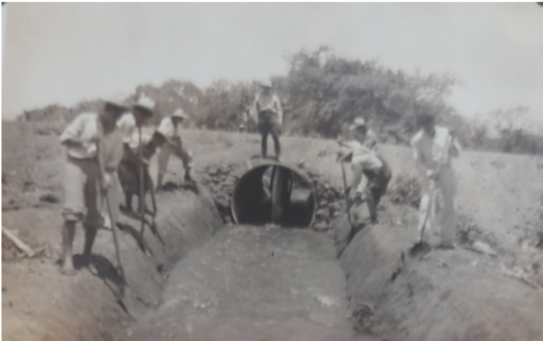
Imagen 2. Canalización de un préstamo adyacente al terraplén del ferrocarril y de la estación de Apatzingán
