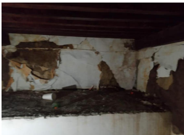
IMAGEN 25. HUMEDADES EN INTERIORES, ANÁLISIS DEL INMUEBLE EN SU ESTADO ACTUAL, 2021
