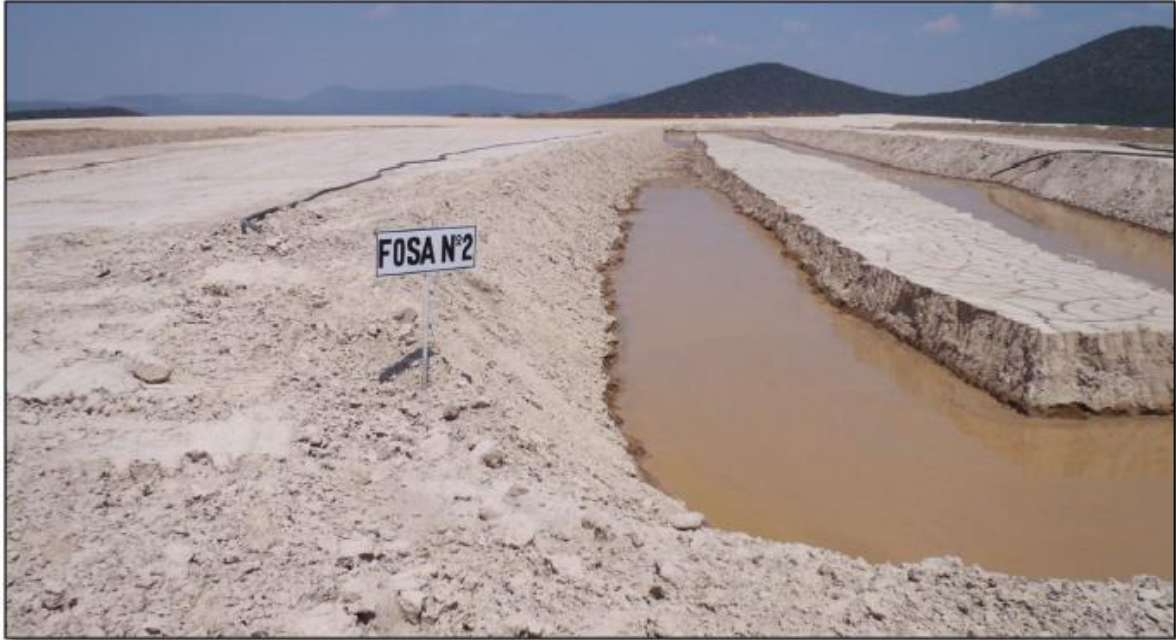
Ilustración 21.- Fosa de secado en la plataforma de apilamiento en seco de San Martín para el almacenamiento temporal de jales lodosos
