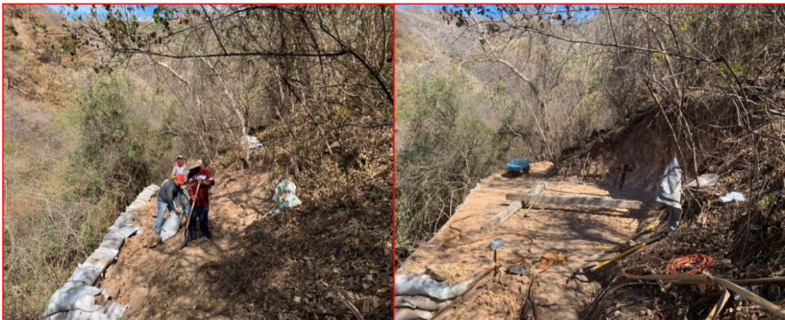
Figura 10. Retiro de maleza y exceso de volumen para dejar un área apta para montar la quinaria.
