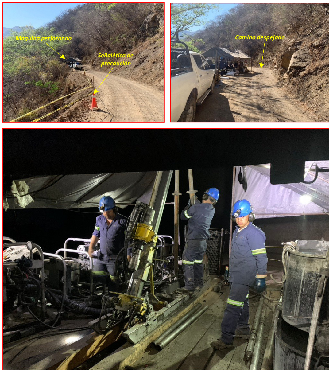
Figura 11. Máquina en operación, respetando el área de trabajo y adaptándola con señalética de precaución al tránsito vehicular.
