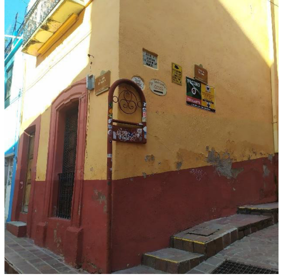
Figura 27 Daño y ausencia de actualización en señalética Fotografía: María José Ramírez
