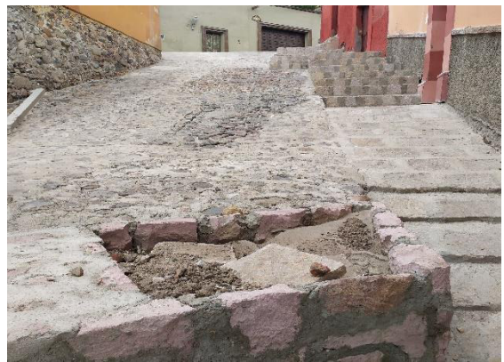
Figura 29 Implementación de nuevos materiales, presencia de baches ante una obra en suspensión Fotografía: María José Ramírez
