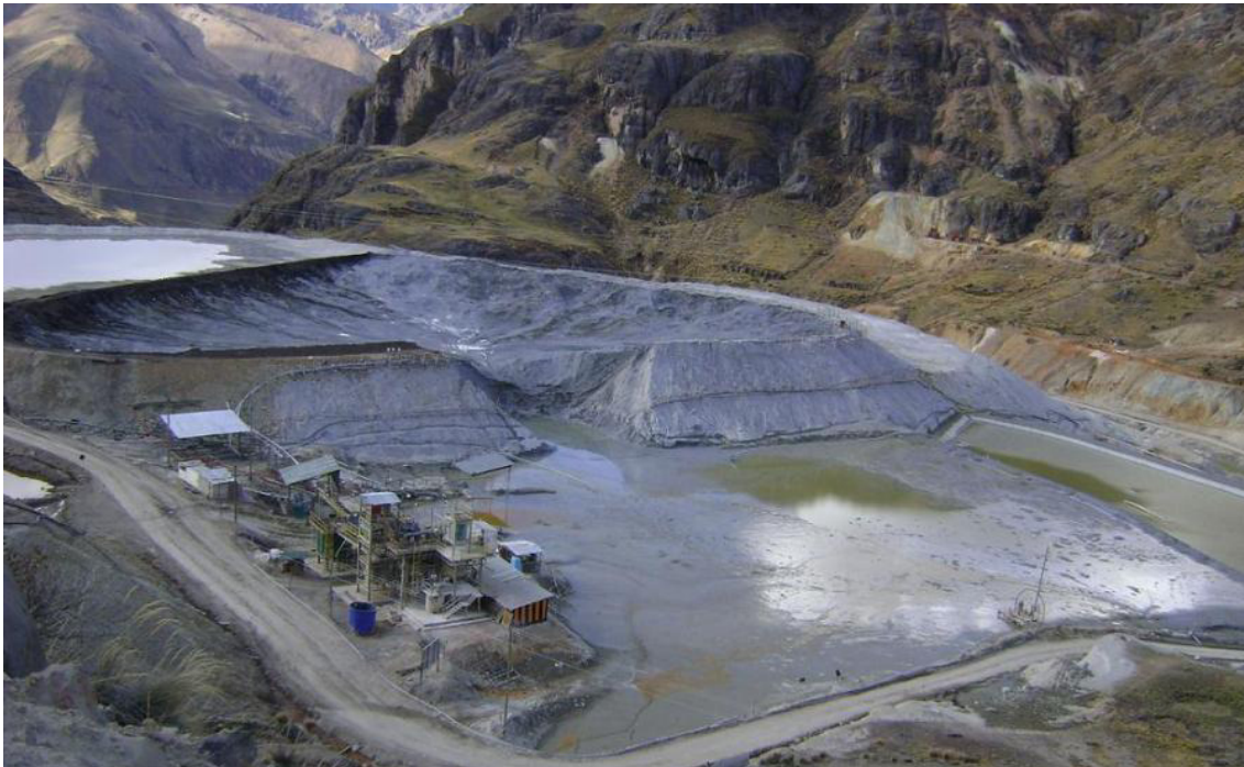
Figura 8.2. Derrumbe parcial de cortina en Presa de Jales de minera Caudalosa Chica, Huanavelica, Perú. Año 2010.
