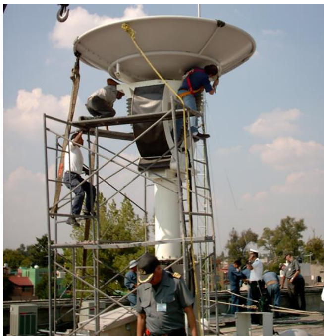
Figura 2.18. Instalación de la Antena receptora de la Estación Satelital ERMEXS en la Secretaría de Marina.
