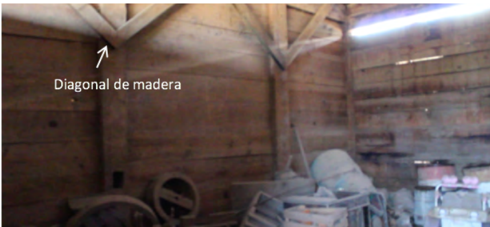
Imagen 33. Cuarto 5: Función de almacén de objetos comunes que ya no son de utilidad para los dueños. Aquí también se aprecia la estructura en diagonal que funciona para mantener rígida la estructura. Fotografía: Berenice Orozco (2018).
