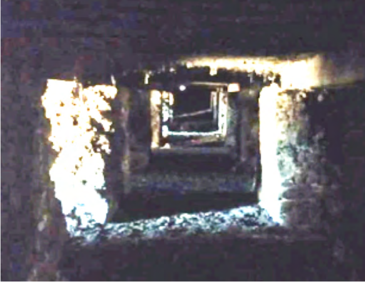
Imagen 17. Interior-cimentación: Se observan los poyos que dan firmeza a la estructura de madera.
