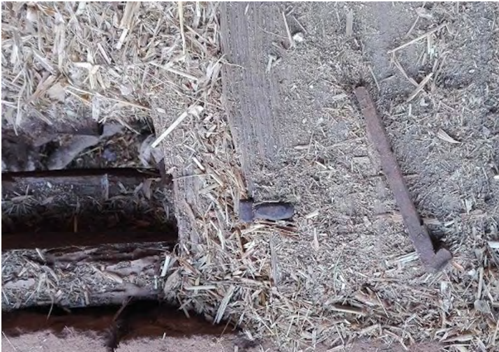
Imagen 45. Clavos encontrados en el entramado de piso, único elemento metálico de la troja de Charahuén.
