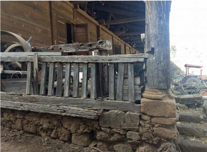
Imagen 19. Fachada Sur: Detalle de baranda y su estado de conservación.
