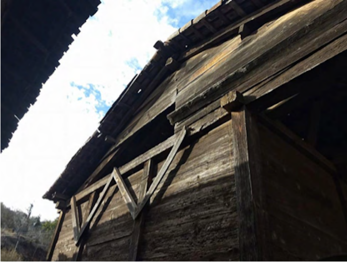
Imagen 18. Fachada sur: Fotografía donde se observan detalles de refuerzos diagonales sobre los pilares, tipo cartabón, y el grado de deterioro de la fachada.
