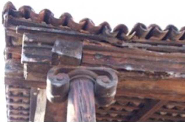
Imagen 28. Detalles de las columnas: Capitel tallado en madera de orden jónico con volutas, decorando la fachada principal de la troje. Fotografía: Berenice Orozco (2018).
