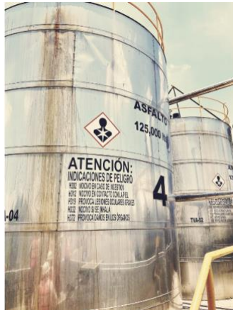
Figura 6: Tanques de almacenamiento de asfalto (tomado de VISE, planta León, Gto)
