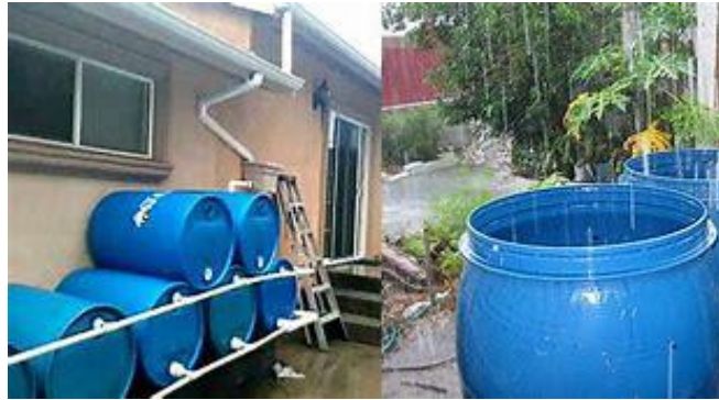
Figura 1. Cosecha de agua de lluvia en zonas rurales. Fuente: Procaprtar 2016
